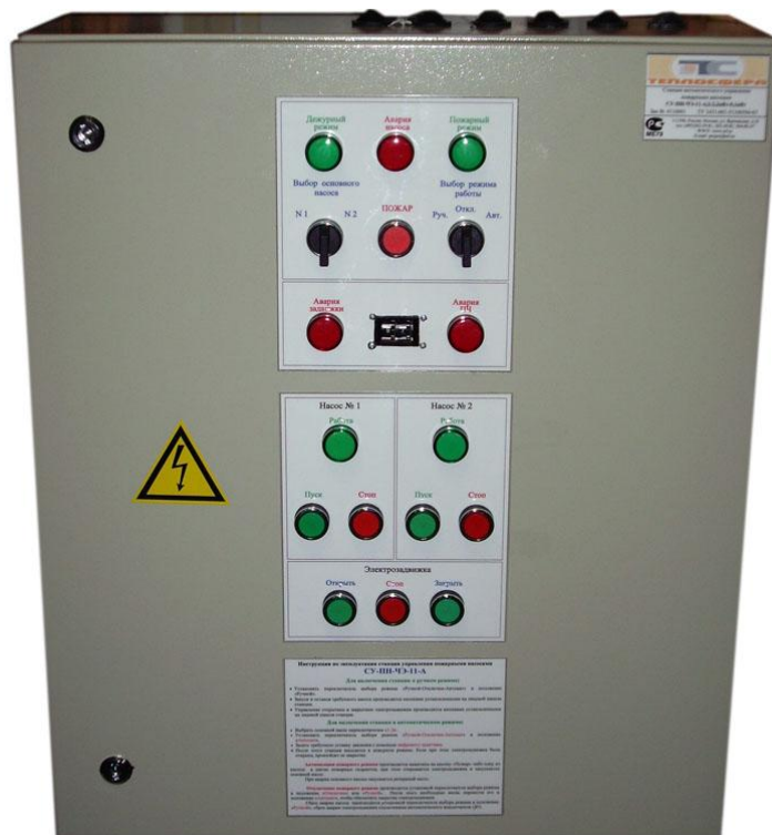
Внешний вид станции СУ-ПН-ЧЭ-221-А
