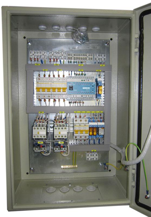
Устройство станции СУ-ПН-220-АД на аппаратуре ИЭК, контроллер ОВЕН ПЛК100
